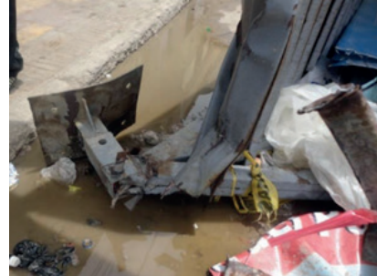
Figura 4. Daños Ocasionados a Estructura Metálica en Bolivia (Nieves Conde)
