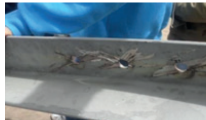
Figura 5: Daños Ocasionados a Estructura Metálica en Bolivia Patricia (Nieves Conde)
